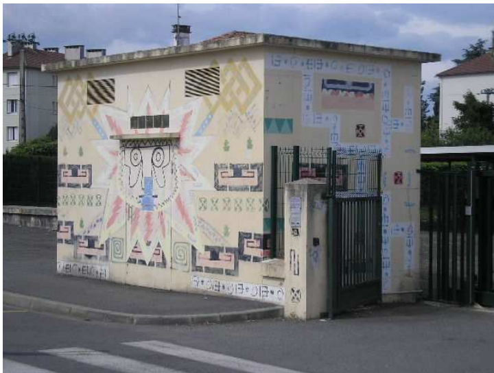
Coupure Générale Electrique Transformateur Energie Services Extérieur Collège à côté ACCES pompiers/fournisseurs
