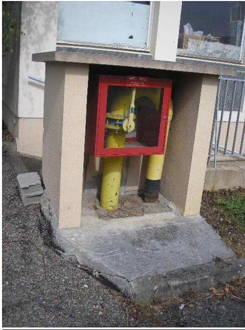
coupure générale GAZ Accès côté portail fournisseur
